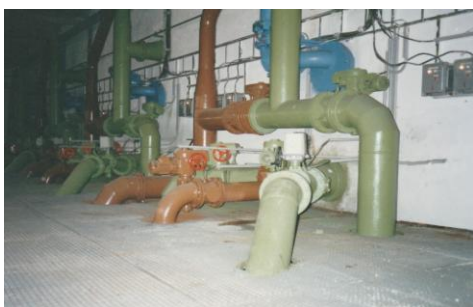
Obrázek 11. Armaturní prostor filtrace
