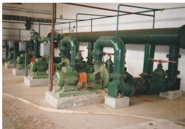
Obrázek 10. Čerpání surové vody
